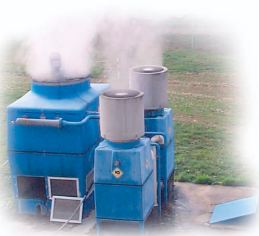
Die 2 MW-Kühlturmgruppe des Kühlsystems.
